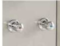
Robinetts eau chaude et froide
